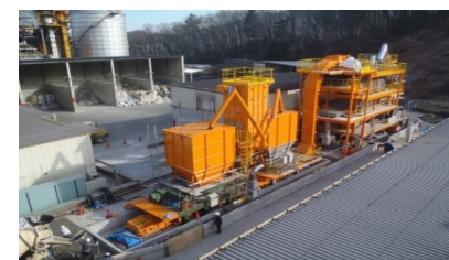
廃プラ・バイオマス処理設備
