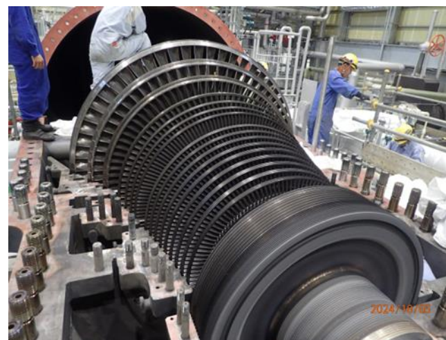
タービン解放点検状況（10月）
