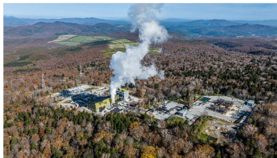
安比地熱発電所全景
