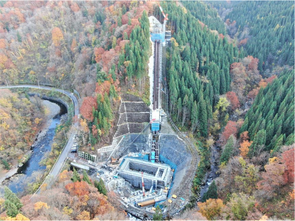
小又川新水力発電所
